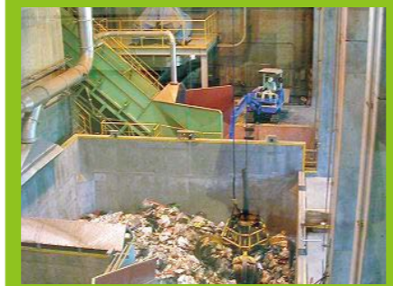
破碎ごみピットとごみクレーン
